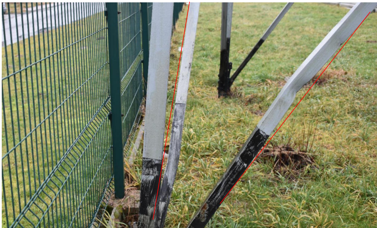
Rysunek 9 Konstrukcja na stanowisku nr 26, linia 2 – uszkodzenie skratowania głównego, ogniwa korozji
