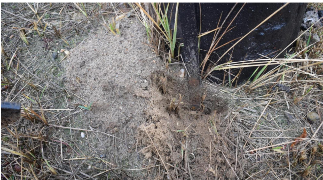
Rysunek 23 Uziemienie stanowisko nr 2 (3), linia 2 – korozja bednarki
