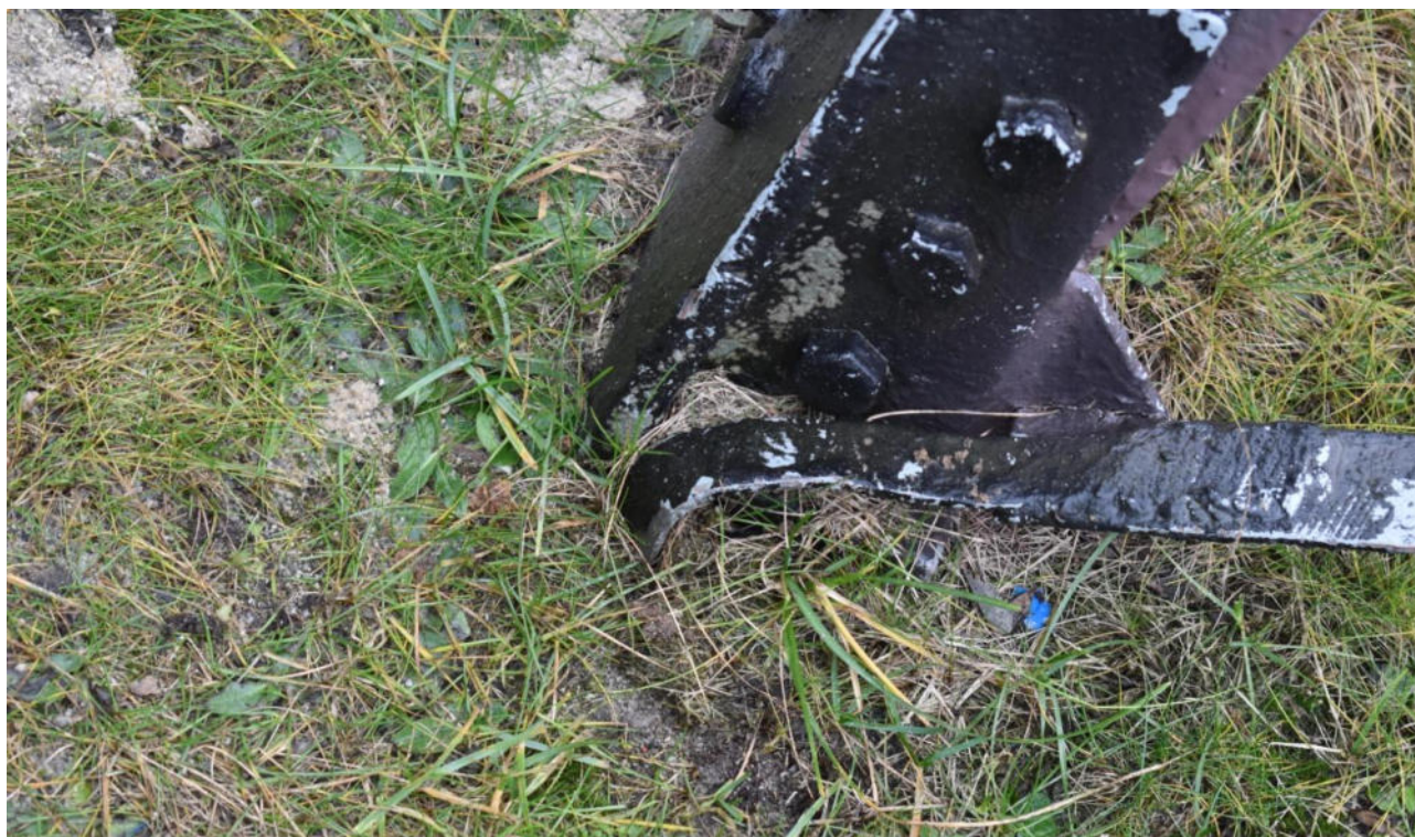
Rysunek 26 Uziemienie stanowisko nr 2, linia 2 – połączenie spawane
