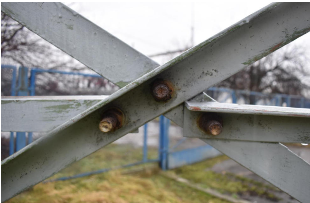
Rysunek 12 Konstrukcja na stanowisku nr 2, linia 1 – korozja połączeń śrubowych
