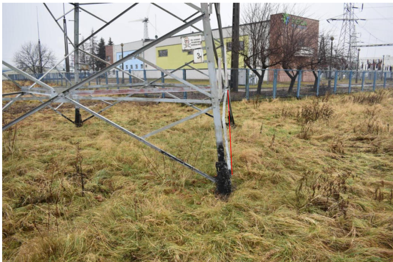
Rysunek 7 Konstrukcja na stanowisku nr 3, linia 1 - wyboczenia skratowania głównego
