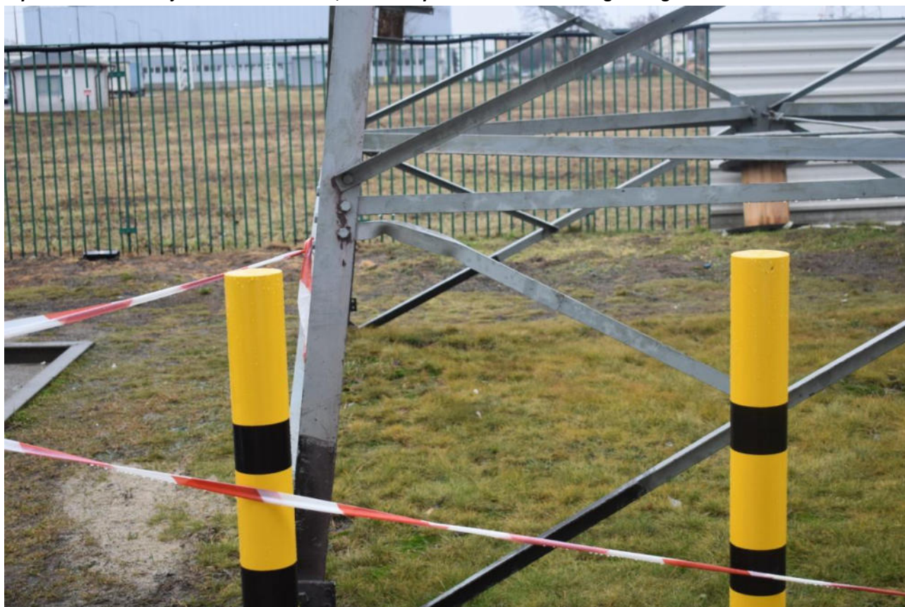
Rysunek 8 Konstrukcja na stanowisku nr 2, linia 2 – uszkodzenie skratowania drugorzędowego, ogniwa korozji
