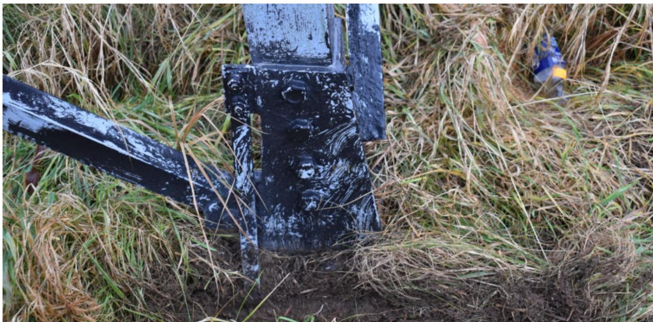
Rysunek 24 Uziemienie stanowisko nr 2, linia 1 – pomalowane połączenia śrubowe
