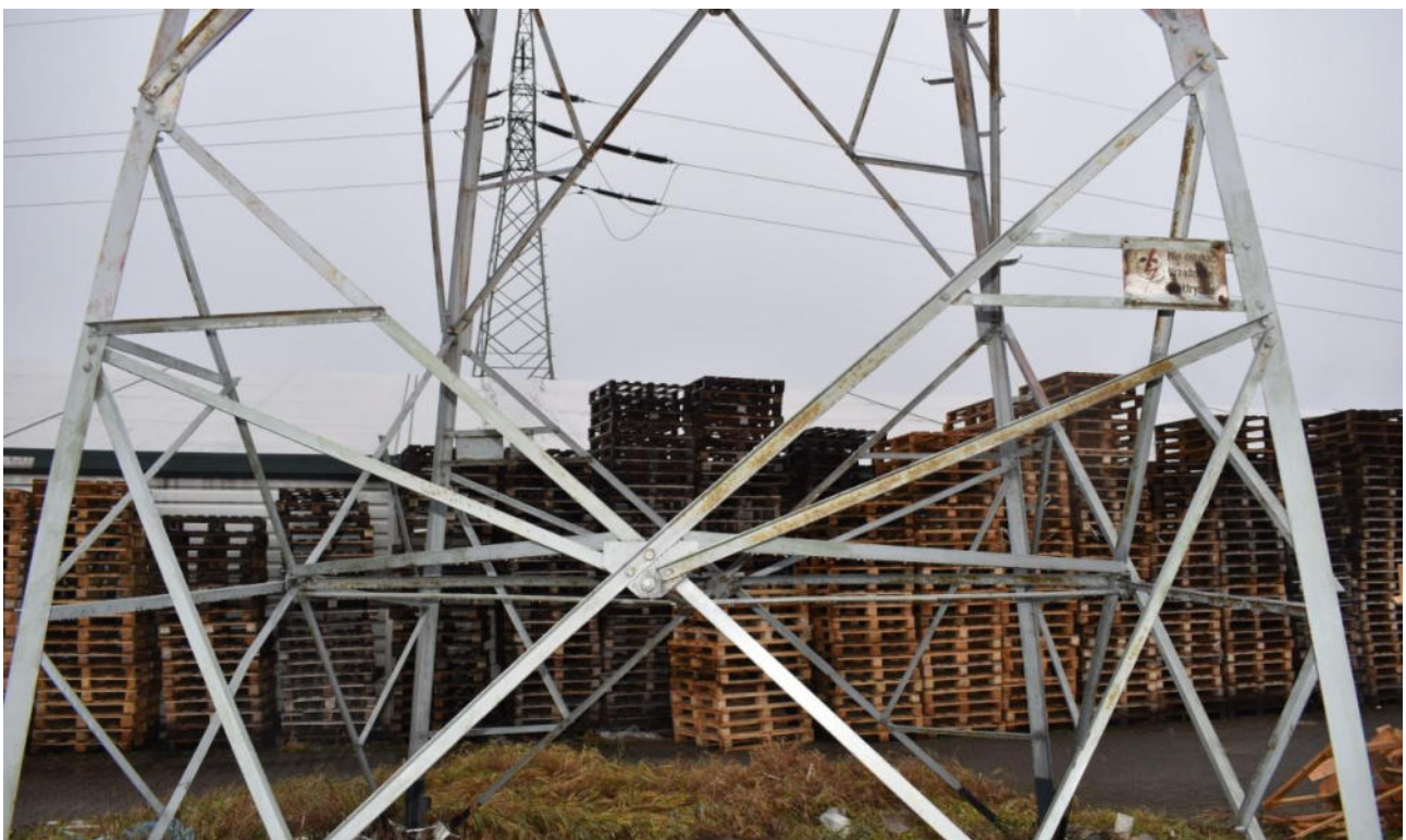
Rysunek 11 Konstrukcja na stanowisku nr 27, linia 1 – korozja kątowników oraz połączeń śrubowych
