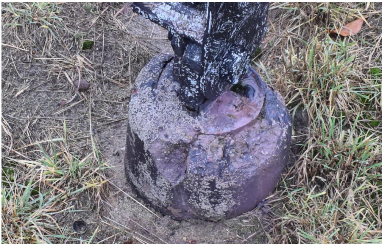
Rysunek 5 Fundament na stanowisku nr 3 linii 2 - pęknięcia, ubytki betonu, odsłonięte zbrojenie
