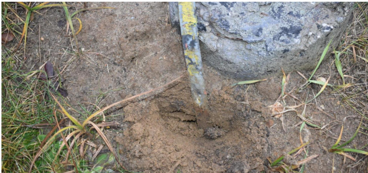
Rysunek 22 Uziemienie stanowisko nr 1, linia 1 – korozja bednarki
