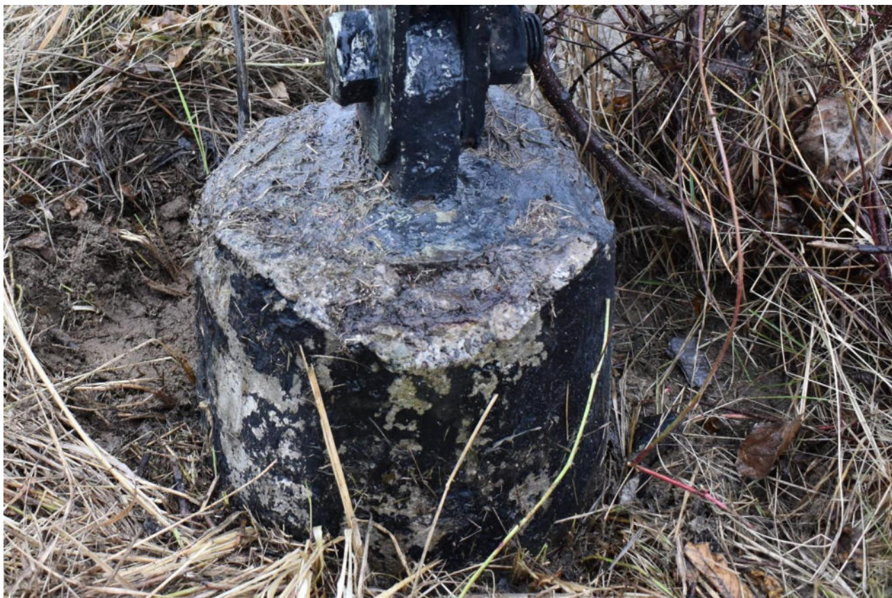
Rysunek 3 Fundament na stanowisku nr 4 linii 1 - ubytki betonu, odsłonięte zbrojenie, uszkodzona hydroizolacja
