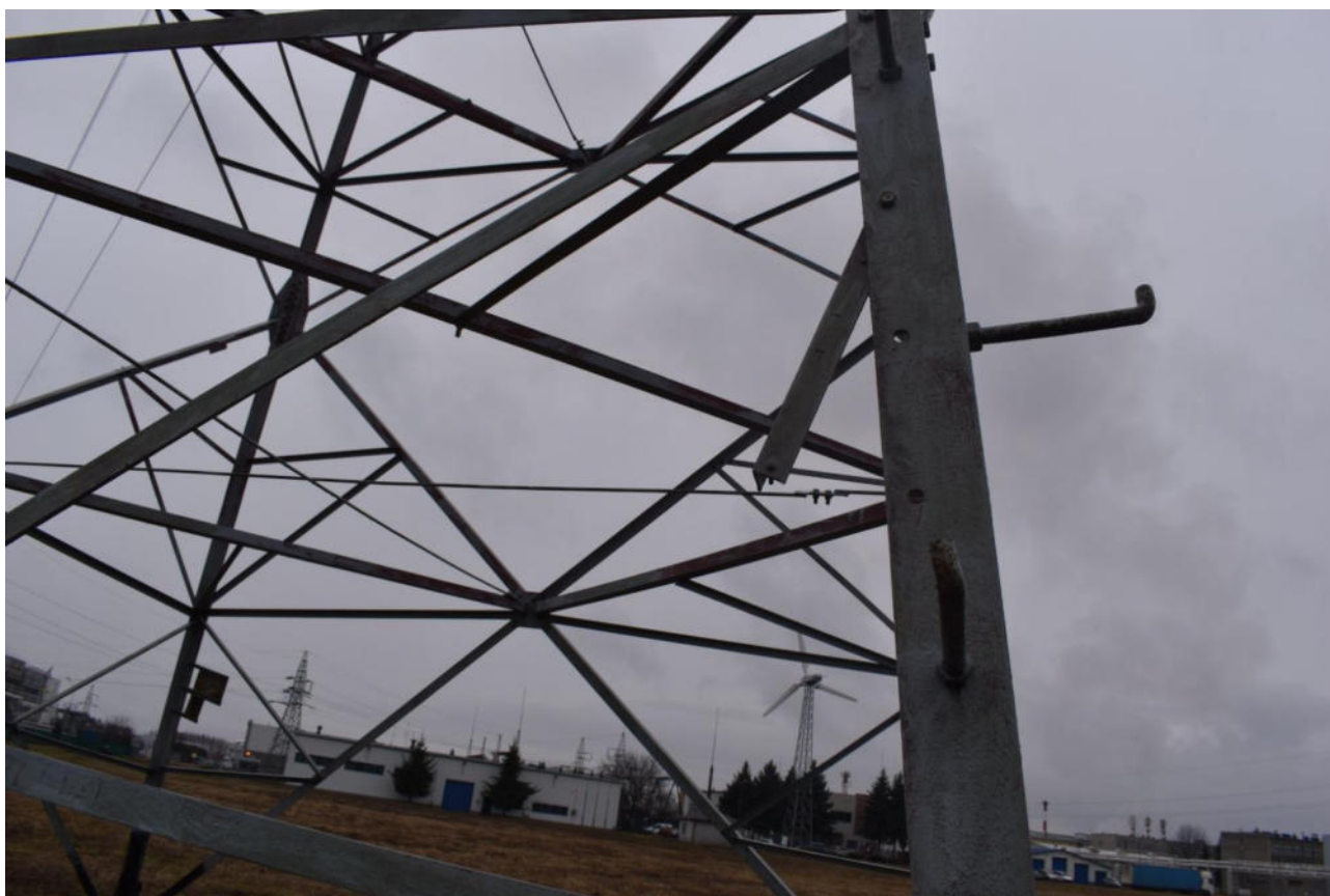
Rysunek 27 Konstrukcja słupa nr 2 (3), linia 2 – oberwana konstrukcja na tabliczki, brak tabliczki ostrzegawczej
