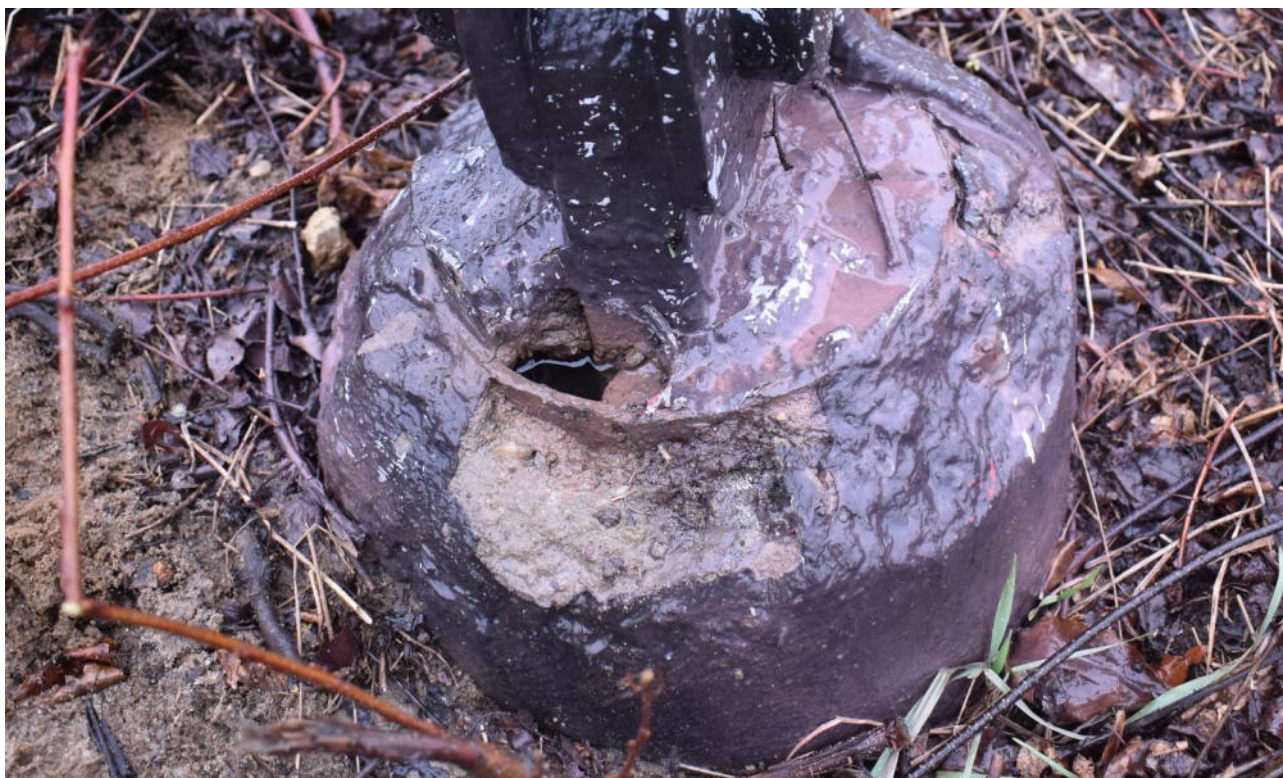
Rysunek 4 Fundament na stanowisku nr 1 linii 2 - ubytki betonu, odsłonięte zbrojenie,
