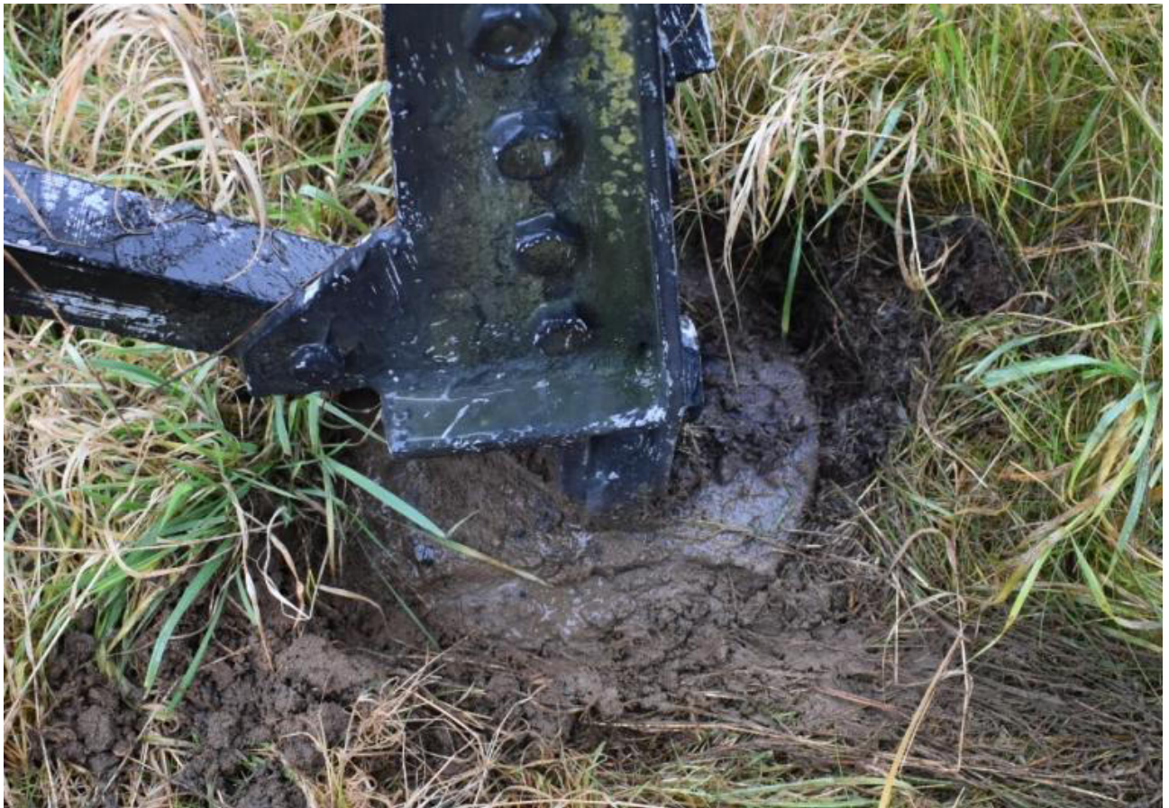
Rysunek 2 Fundament na stanowisku nr 2 linii 1 - zasypyany, ubytki betonu
