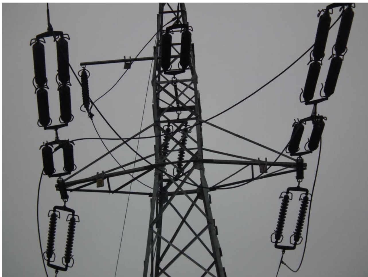
Rysunek 18 Przewody fazowe stanowisko nr 26, linia 2 – szczegół przeplotu faz
