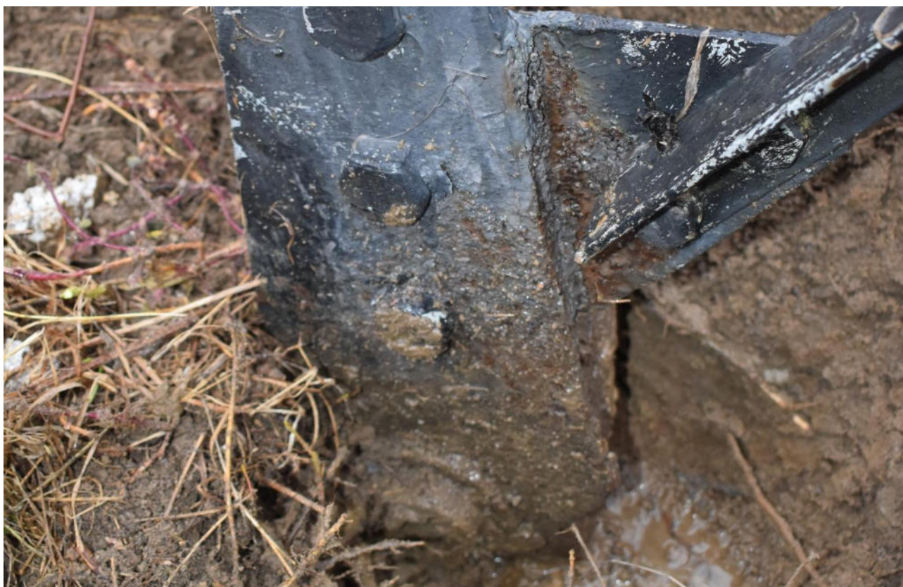
Rysunek 6 Stopa zawiasowa na stanowisku nr 27, linia 1 – korozja stopy oraz kotwy fundamentowej
