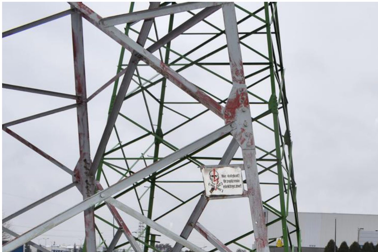
Rysunek 13 Powłoka malarska na stanowisku nr 1, linia 2 – widoczna warstwa podkładowa
