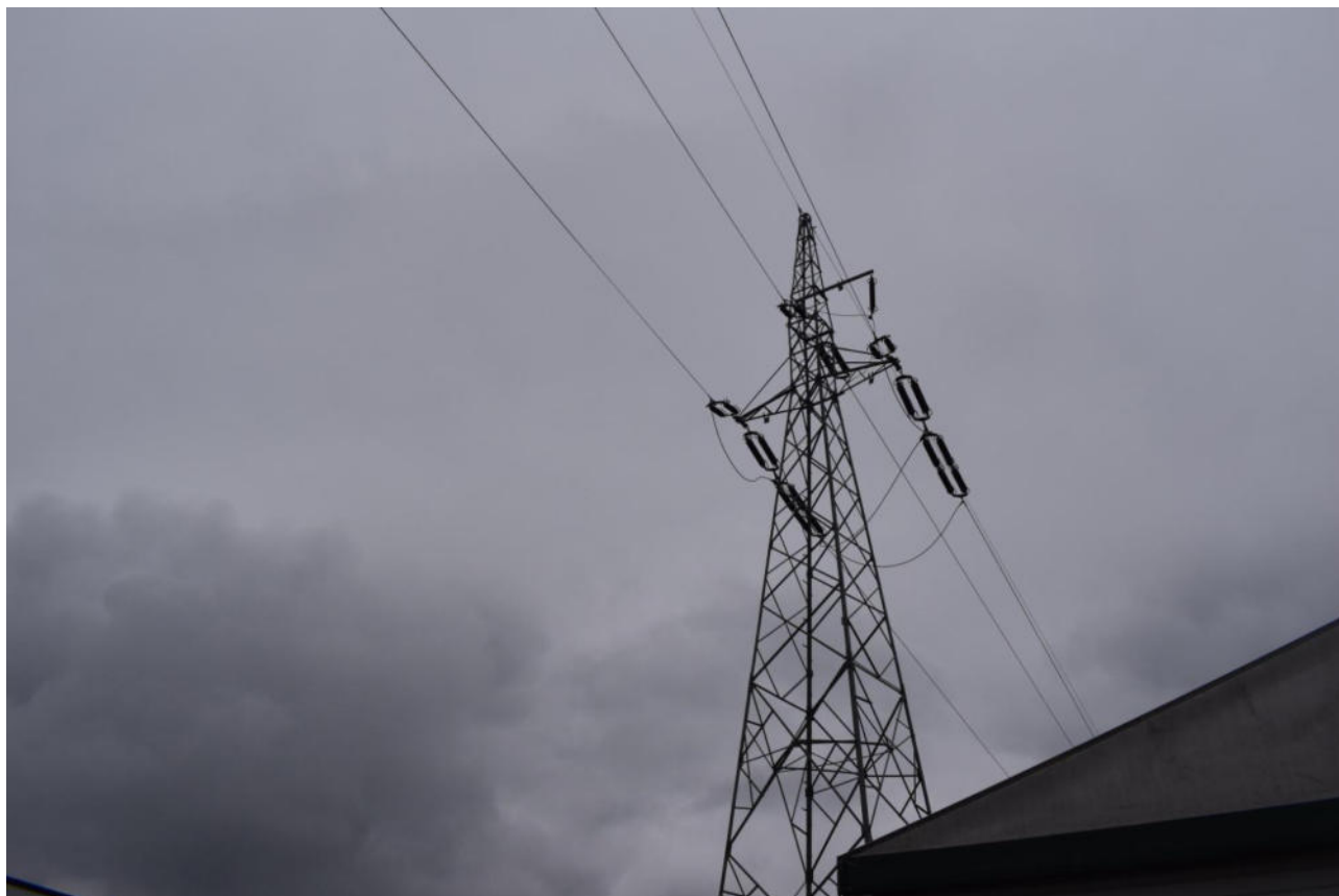
Rysunek 17 Przewody fazowe stanowisko nr 26, linia 2 – przeplot fazy R i T
