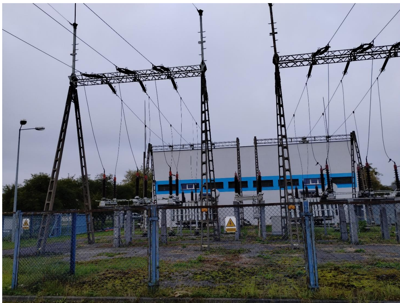
Zdjęcie 1 – Istniejąca rozdzielnia napowietrzna 110 kV stacji E1
