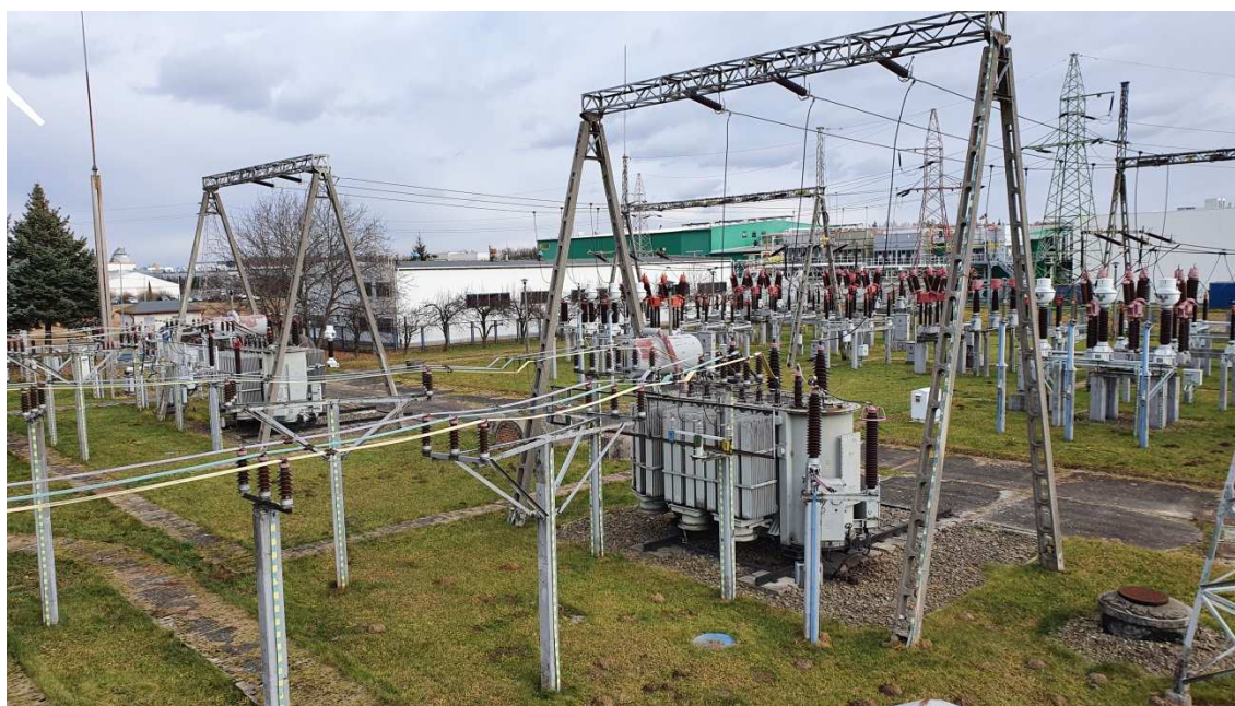
Zdjęcie 1 – Istniejąca napowietrzna rozdzielnia 110 kV
